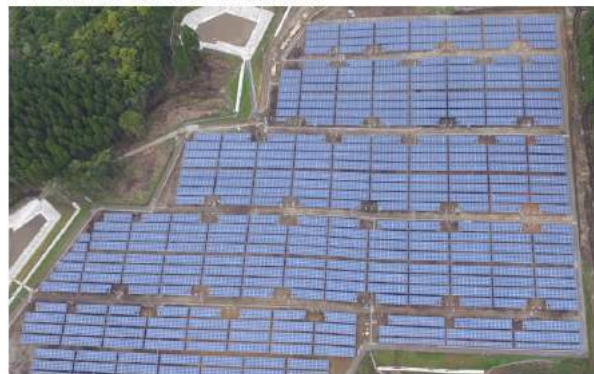
宮之浦太陽光発電所（鹿児島県）
