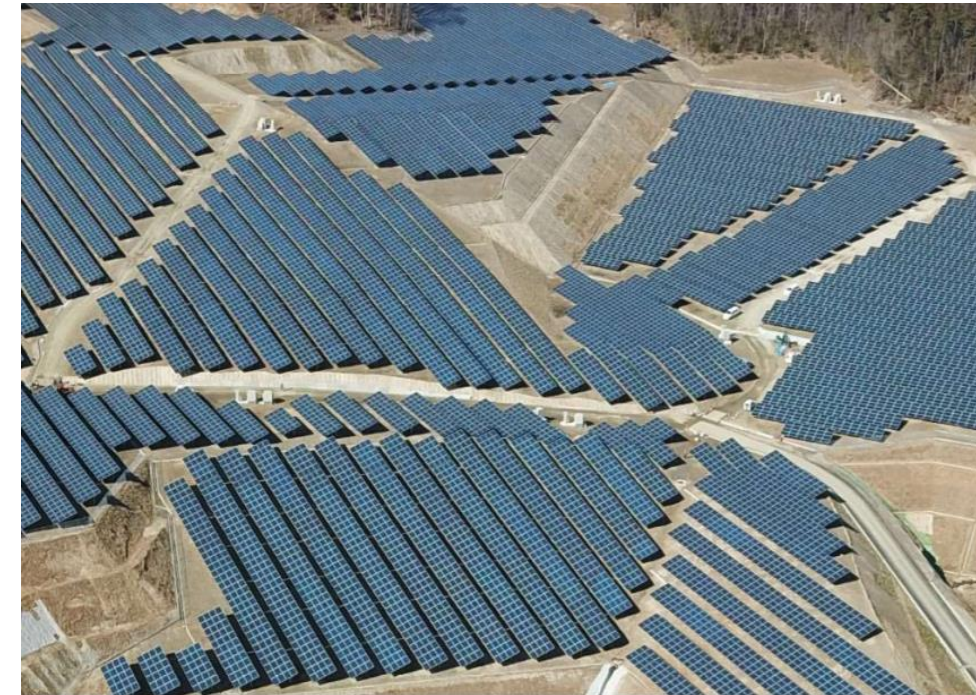
【Kakuda solar power plant】
